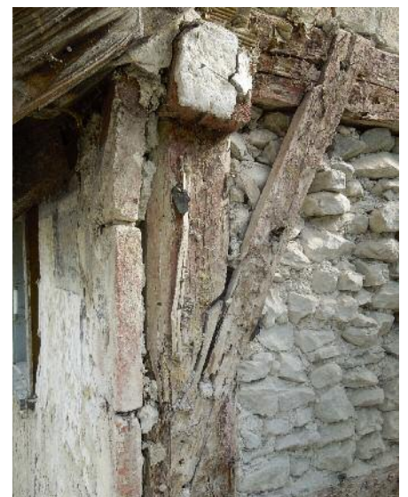
Bauzeitliche Vorblendung von Tonplatten vor das Fachwerk; auf den Platten lagen eine Tünche und mehrere Farbfassungen in rot und grau.
