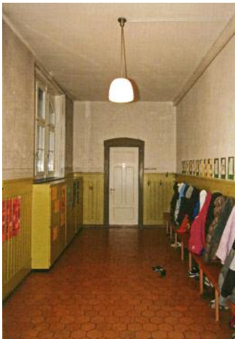
Bild vorher: Die seit den 1940er Jahren mit intensiven Farben gestrichenen Täfer in den Korridoren. Der Boden mit Wabenplatten stammt aus der Bauzeit.
