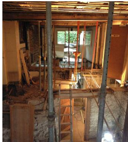
Aufgrund stark verfallener Balkenköpfe wurden in einer ersten Etappe Teile der Balkenlage und die Bodendielen über dem Kellergeschoss erneuert.
