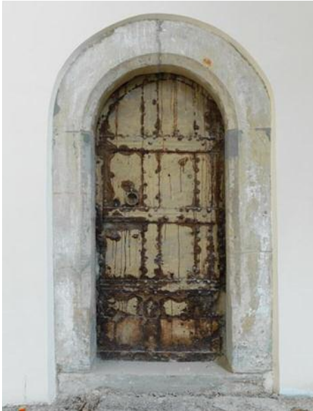
In der Nordwand konnte eine zugemauerte Eisentüre aus dem 15. Jahrhundert freigelegt werden. Hier sichtbar ist der Zustand vor der Restaurierung.
