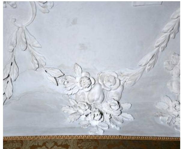
Die Frucht- und Blütenkompositionen an der Hohlkehle entstanden wohl später als die flächeren Band- und Girlandenstukkaturen an der Decke. Sichtbar sind hier auch Risse und jüngere Ausbesserungen. Foto 2013.
