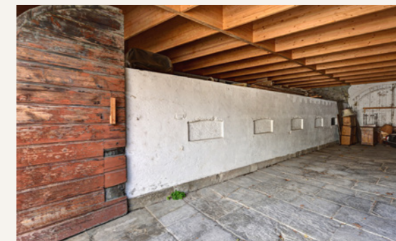
La paroi des anciennes écuries, derrière laquelle sont logés la chaudière et le stock de pellets.
