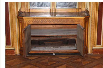
Château de l'Aile, Vevey: depuis sa reconstruction néogothique en 1840, un réseau d'aéroducs invisibles pourvoit tout le bâtiment en chauffage à air pulsé. Ici, le conduit débouche dans le buffet de la salle à manger. L'air chaud est diffusé dans la pièce par le biais d'une fente ménagée dans le socle, mais passe également à l'intérieur du meuble, qui fonctionne dès lors comme chauffe-plats.
