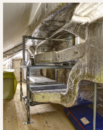
Echangeur de chaleur installé dans la soupenne d'une annexe.
