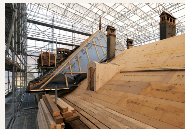
Isolation des ailes latérales (entre chevrons, avec panneau de sous-couverture) et des pavillons de tête (sur chevrons). Le réveillon visible sur la gauche amortit la surépaisseur ainsi créée.
