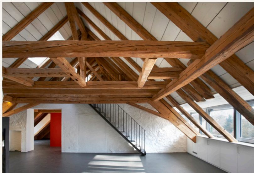
La charpente de 1740, conservée et mise en valeur. La trémie et les chevrons interrompus correspondent à l'emplacement d'un ancien «dôme» servant au chargement par le toit de produits agricoles.
