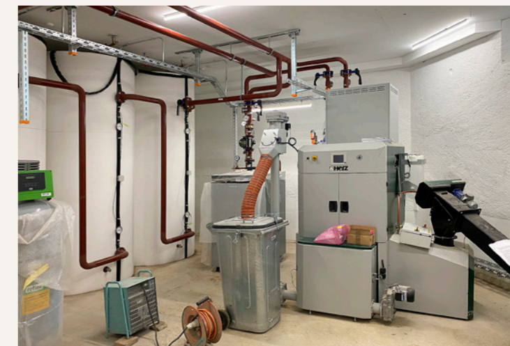
La nouvelle centrale thermique aux plaquettes forestières. On notera la taille très réduite de ces installations, sachant qu'elles desservent les quelque 7 000 m 2 de plancher du château. À droite, la vis d'alimentation en combustible; à gauche, les accumulateurs servant à uniformiser la distribution de chaleur.
