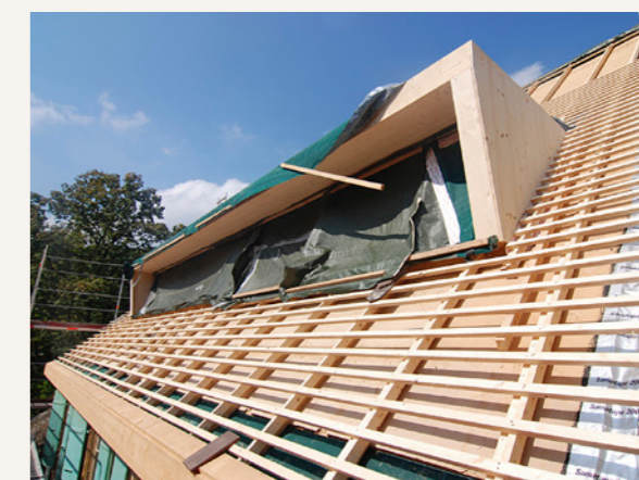
L'isolation de toiture, composée de ouate de cellulose et d'une sous-couverture en fibre de bois.
