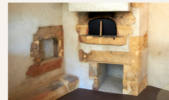
L'ancienne chaufferie au rez cachait un four à pain historique, restauré et remis en fonction à l'occasion des travaux.
