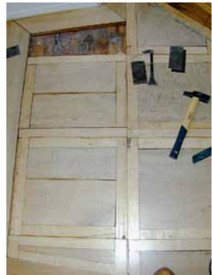
Abb. 3: Sondieröffnung Tafelparkett; die Oberfläche ist stark vergilbt, weisslich.
